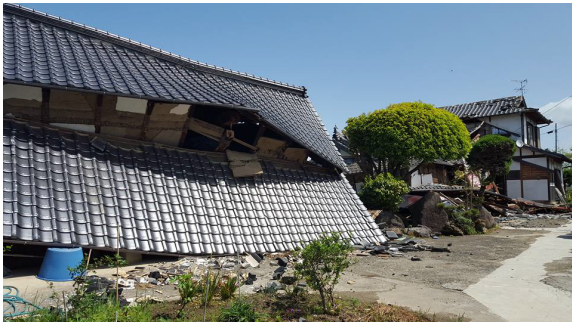
家屋が倒壊した熊本市嘉島町鯉の集落
